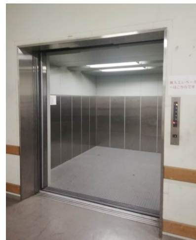
搬入用エレベーター
