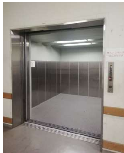
搬入用エレベーター
